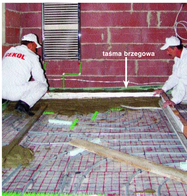
Rys. 7. Taśma brzegowa jako niezbędny dodatek przy układaniu każdej podłogi (zwłaszcza z zainstalowanym ogrzewaniem).
