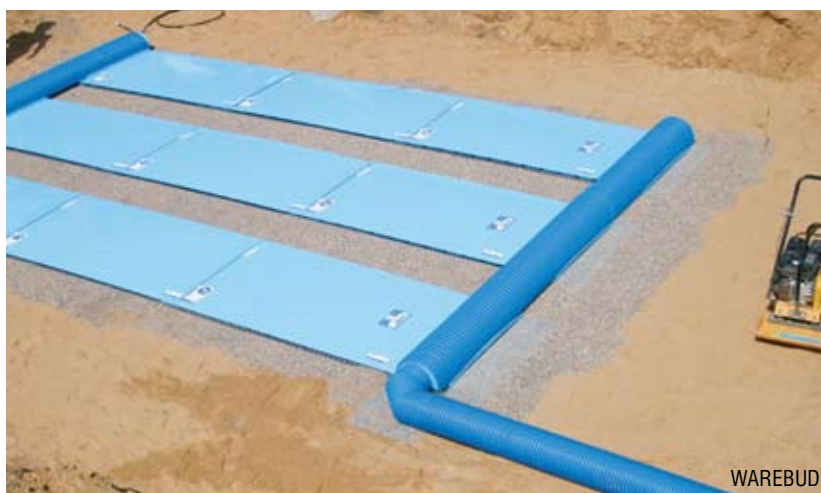
Fot. 8. Panele i przyłącza płytowego gruntowego wymiennika ciepła przed obsypaniem gruntem, ułożeniem styropianu itd.
