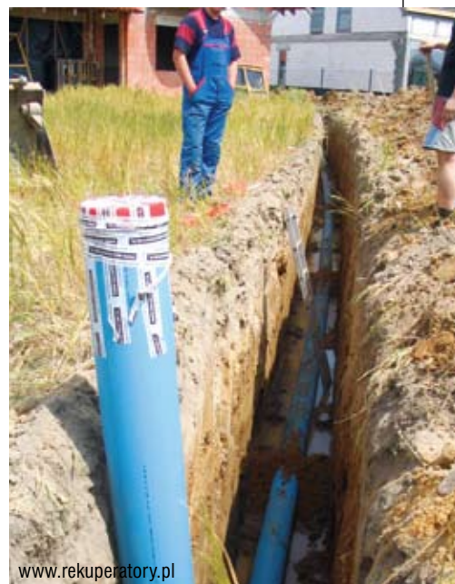
Fot. 2. Realizacja antybakteryjnego GWC w formie prostej rury doprowadzonej do budynku.
